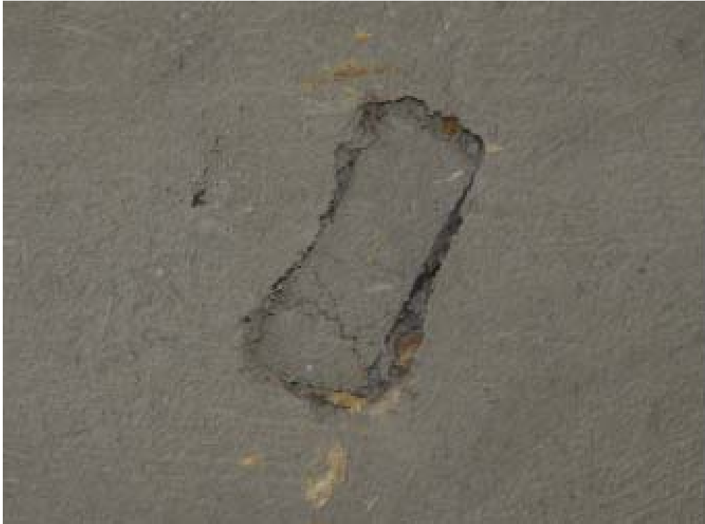
Pannello della serie V colpito dal terzo missile del test anti-tornado
